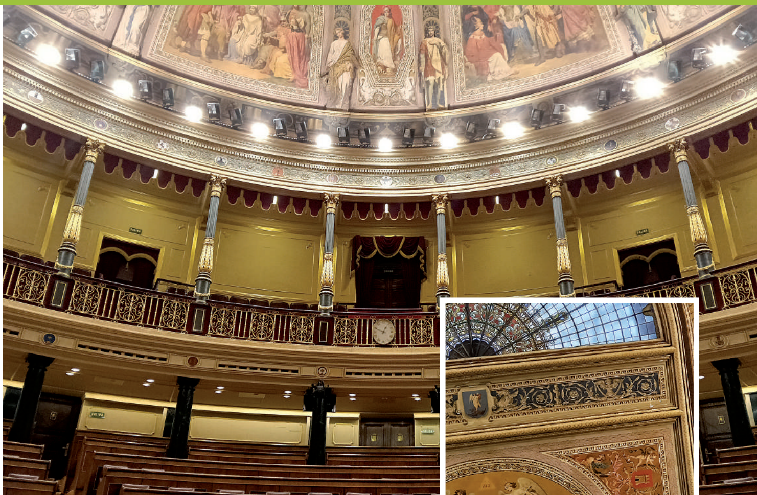
Salón de plenos del Congreso y escaños. En el recuadro, daños por las balas del 23-F
